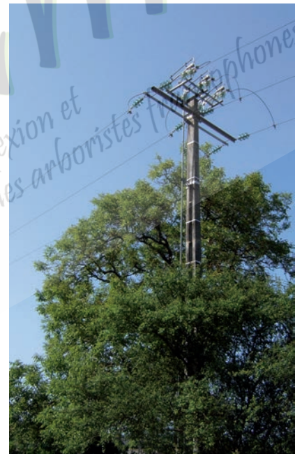
Ligne haute tension de type A (HTA).
