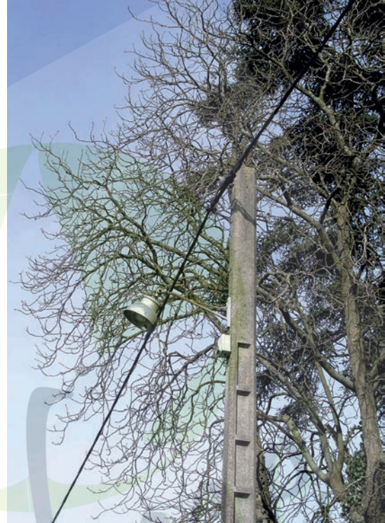
Ligne basse tension (BT), réseau isolé.
